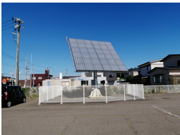
図1: 由利本荘保健所に設置されている太陽光パネル
